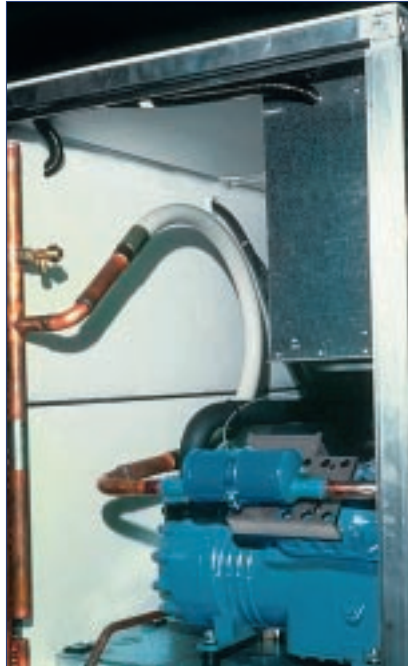
Рис 3. Компрессор, оснащенный глушителем и вибровставками на всасывающем и нагнетательном трубопроводах
