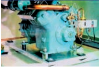
Рис 2. Компрессор, установленный на виброосновании
