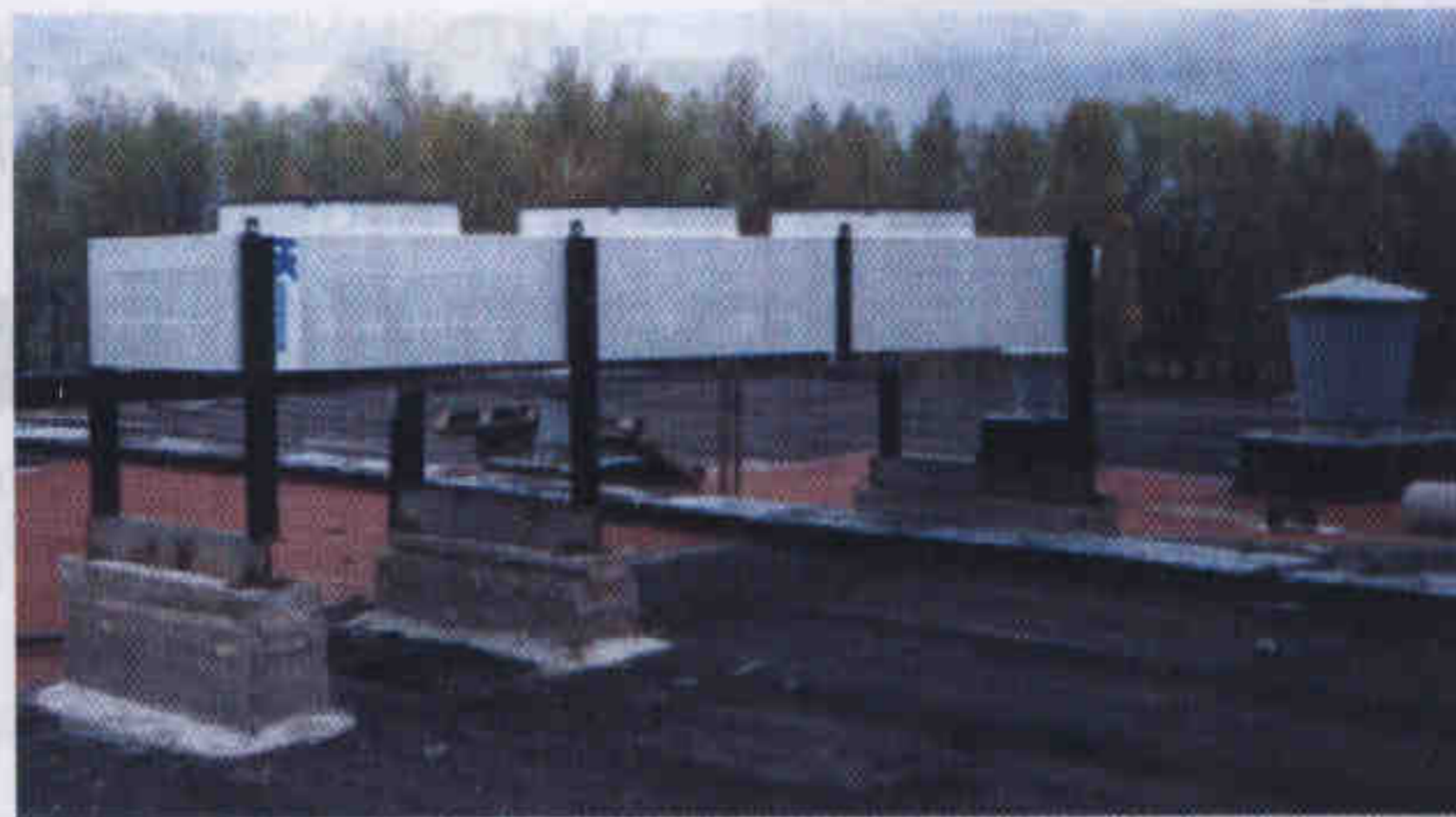
Воздушный конденсатор серии Havane H9, установленный на крыше овощехранилища
