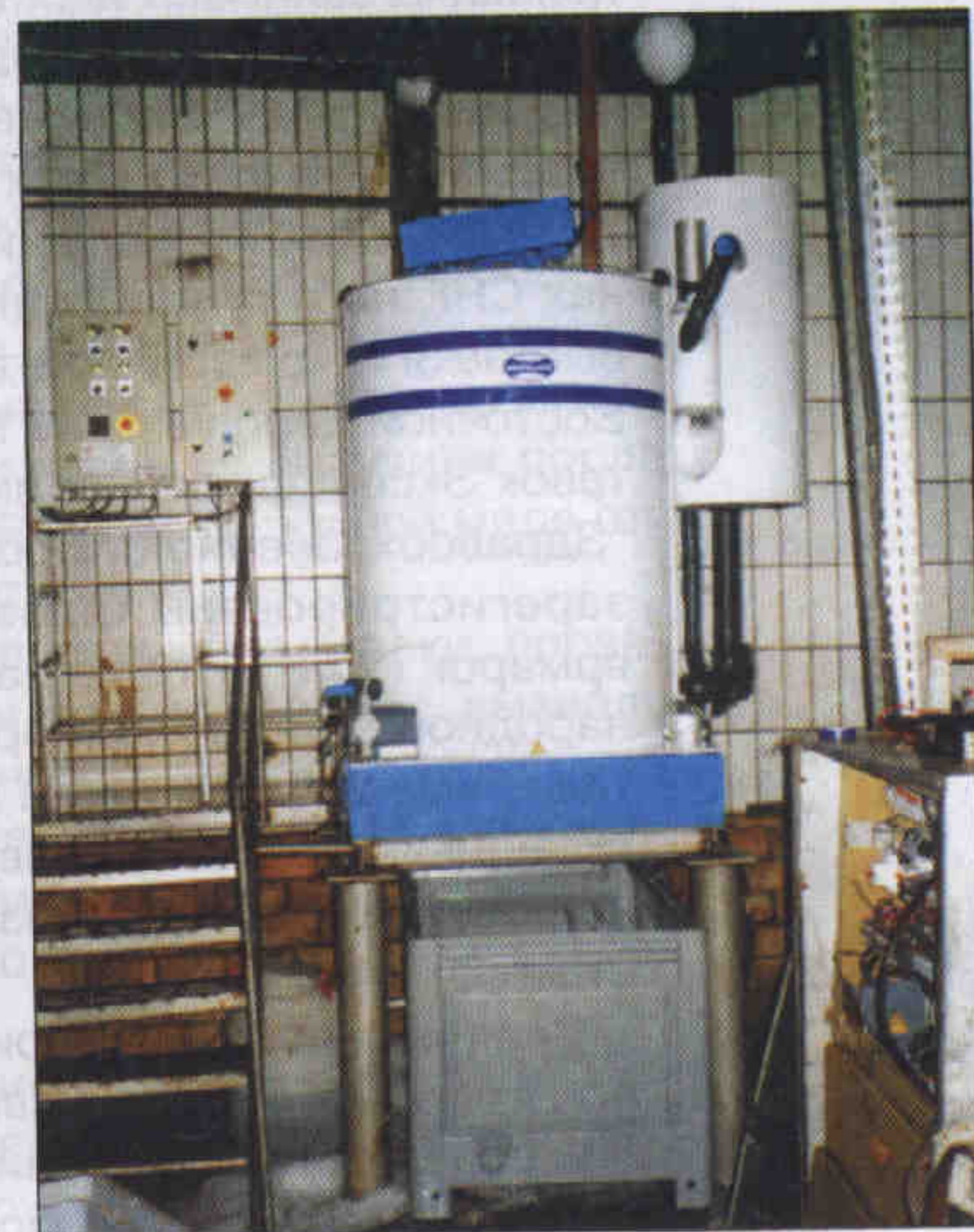
Аммиачный льдогенератор GENEGLACE, мощностью 10 т/сут, установленный на Царицынском мясокомбинате
